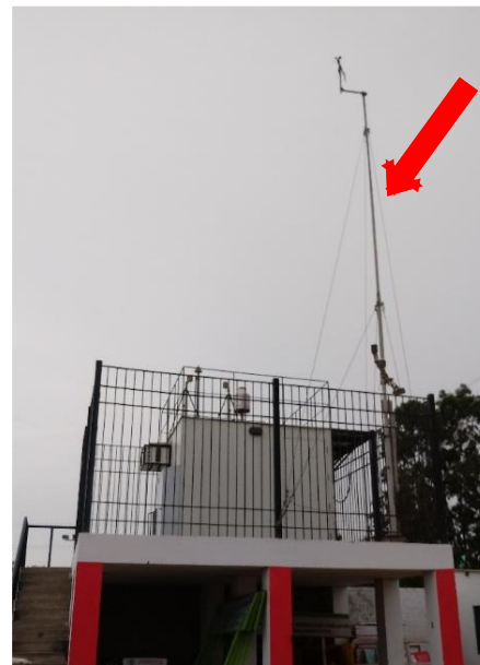
Estación meteorológica automática
