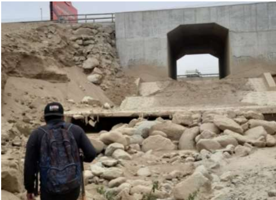
Figura 57. Visualización de la presencia de socavación en estructuras hidráulicas (puente), dentro del lecho natural de la Quebrada Malanche – Punta Hermosa.
