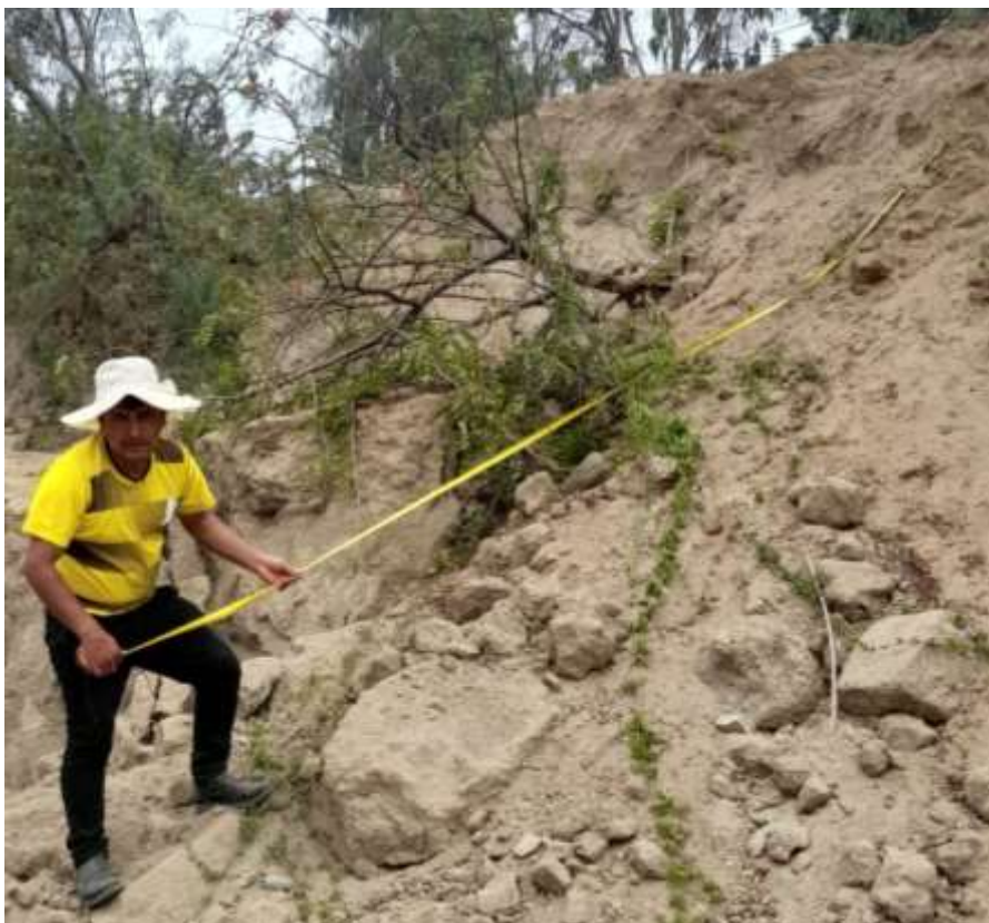
Figura 55. Medición del ancho y altura del lecho natural de la Quebrada Malanche – Punta Hermosa.
