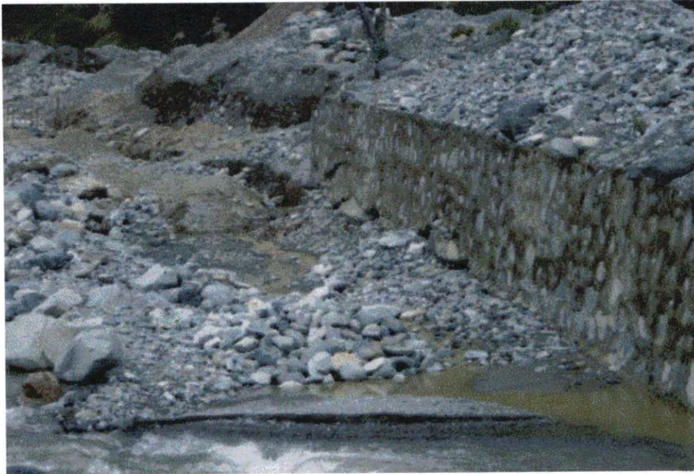
Fotografía 4. Río Llacuabamba muro de contención socavado su base
