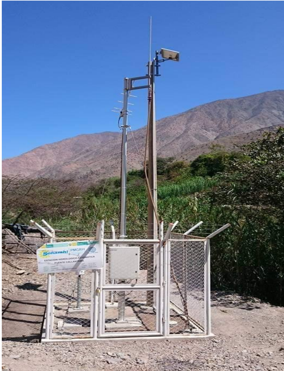
Figura 2. Estación meteorológica automática del Servicio Nacional de Meteorología e Hidrología del Perú – Puente Callantama en la provincia de Huaral en el departamento de Lima.
