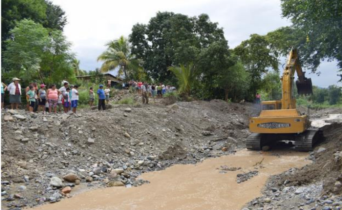
Imagen 7. Lugar en el que ocurre desborde de las aguas – progresiva 0 + 420 Km del plano de inundación
