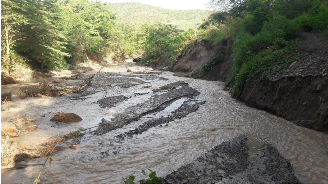
Imagen 5. Vista de taludes con riesgos de erosión – altura de la progresiva 0 + 600 Km de los planos de inundación
