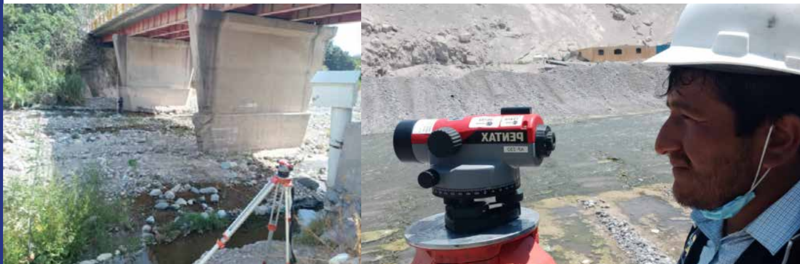
Seccionamiento de cauces de control hidrométrico para vigilancia de niveles y caudales (DZ7)
