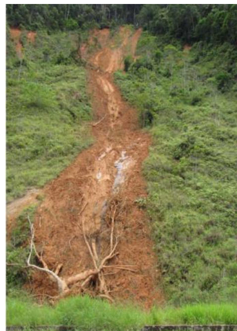
Figura 2.15 Erosión de suelo y deslizamiento en el río Santos Highwa - Brasil Fuente: María do Carmo Oliveira Jorge, 2009
